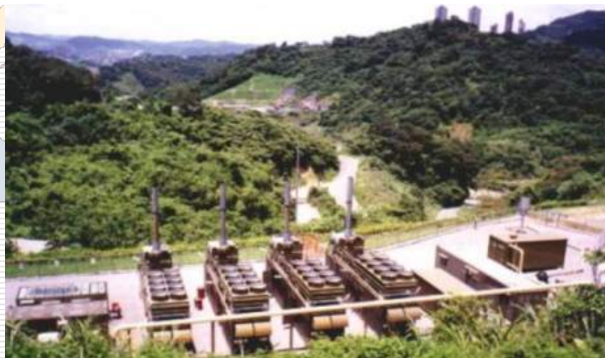
山豬掩埋場沼氣處理發電廠
